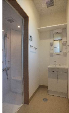
洗面台・シャワールーム
